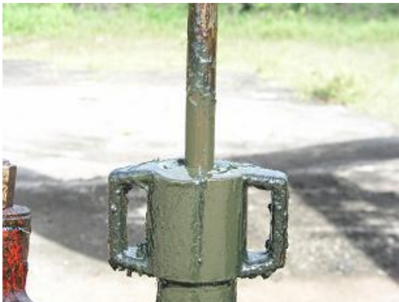
Vazamentos gerados por desgaste de hastes polidas
