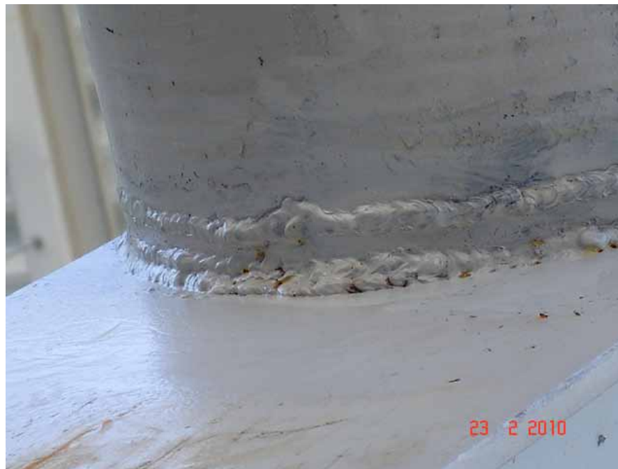
Junta com Cordão desalinhado e Mordedura
