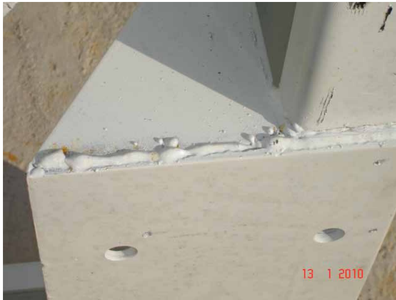
Junta com Mordedura Falta de Fusão e Respingos.
