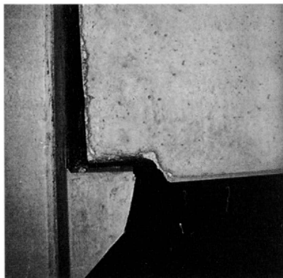
Essa viga-mestra de concreto se apóia na saliência, que se pretende que atue como uma superfície de contato sem atrito. (6)
