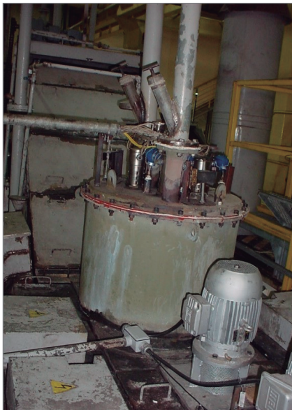
Fig. 1. Recuperador de sal montado diretamente em cima do forno a banho de sal
